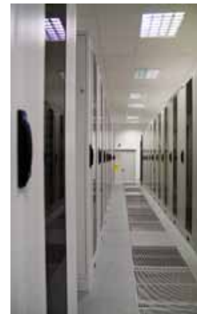
Salle de serveurs informatiques disposant des dernières technologies
